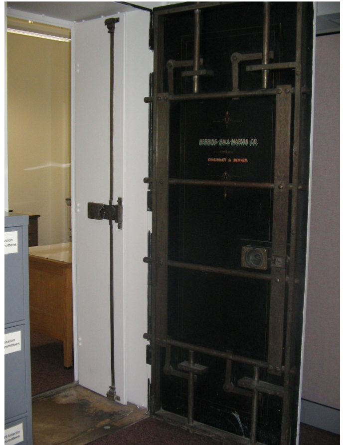
045A Vault door
